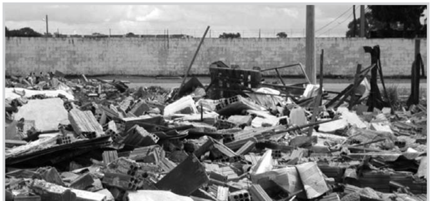
Escombros de construcción.
