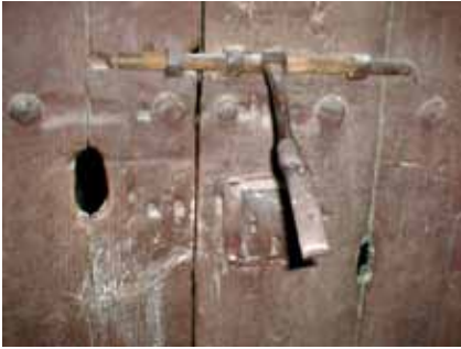
Cerrajería en puerta antigua.
