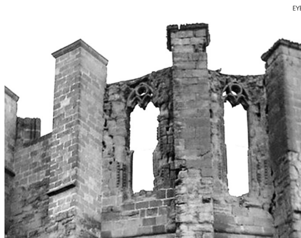
Estado de parte de la iglesia de Santa M a de Atienza, en Huete.
