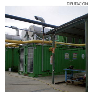
En la imagen, una planta de biodiésel.
