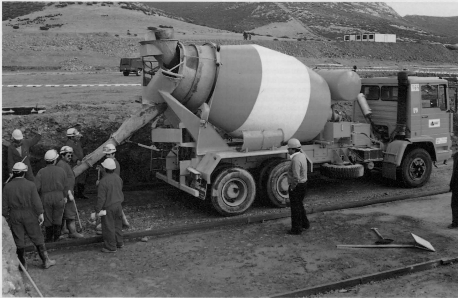
El primer camión hormigonera deposita el cemento para contruir los pilares del edificio sobre el que se asentará la turbina de gas
