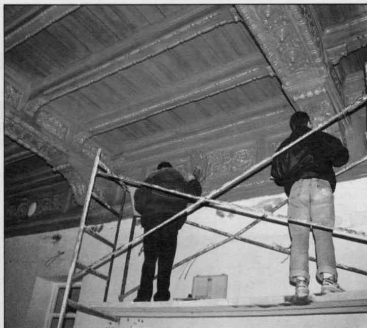
Detalle de la restauración del artesanado y paredes del interior del antiguo Ayuntamiento
