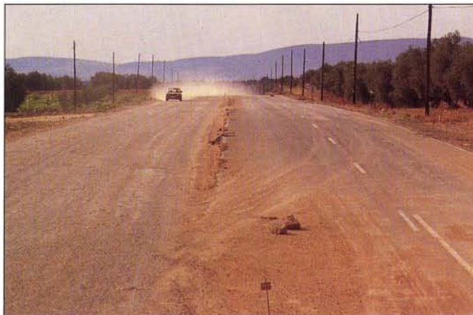
Más de cinco kilómetros están sin asfaltar
