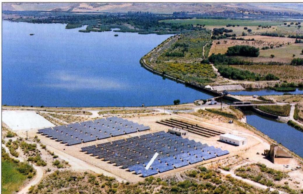
Toledo PV es la primera central solar que se engancha a una línea eléctrica para uso comercial.
