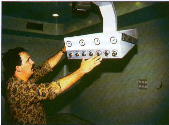
Un detalle de uno de los seis quirófanos de que dispondrá el hospital.
