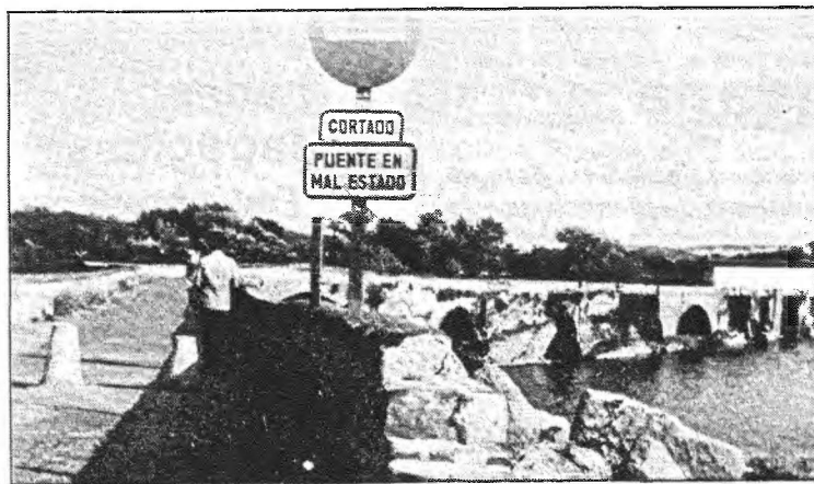
Pese a la prohibición existente y su ruinoso situación, el Puente Viejo o Puente Romano sigue utilizándose por parte de los transeúntes.
