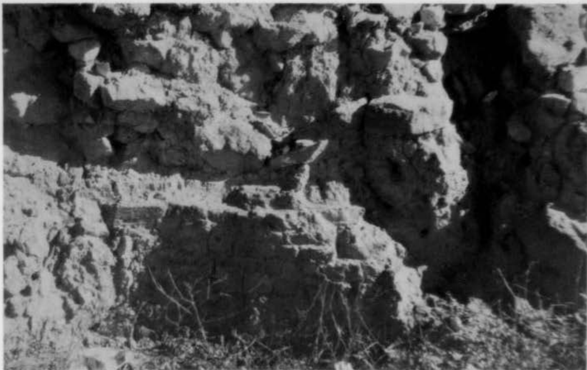
Fot. n.º 9: Aspecto actual del interior del horno árabe de la tejera. Se puede apreciar el doble muro de la construcción. El externo, grueso, de mampostería tosca; el interior, casi totalmente desprendido, de ladrillo refractario.
