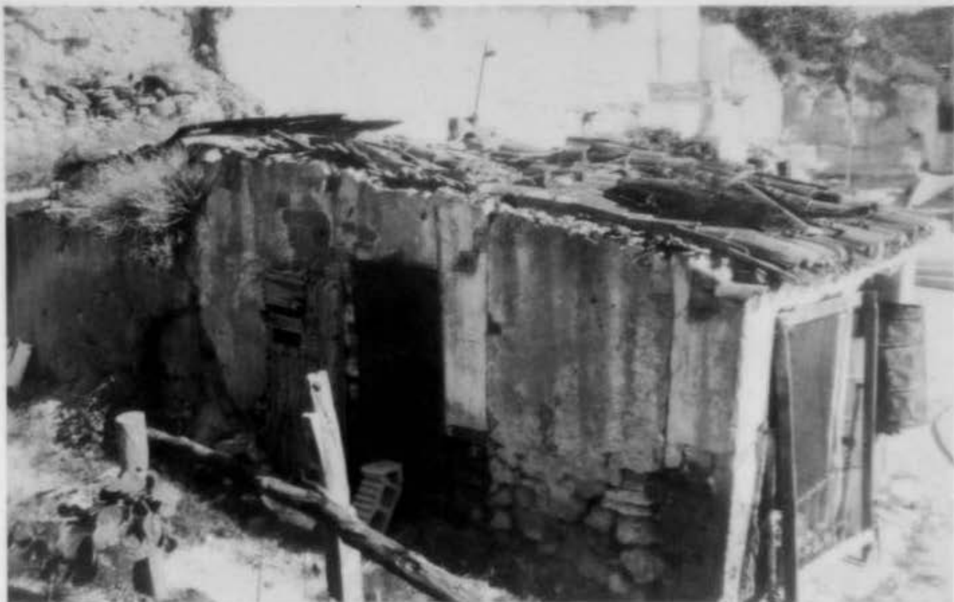
Fot. n.º 7: Exterior del horno árabe de los hermanos Tortosa. En la parte delantera, el leñero; en la posterior, el horno cubierto con chapas metálicas. Se puede apreciar perfectamente el estado semi-ruinoso en el que se encuentra.
