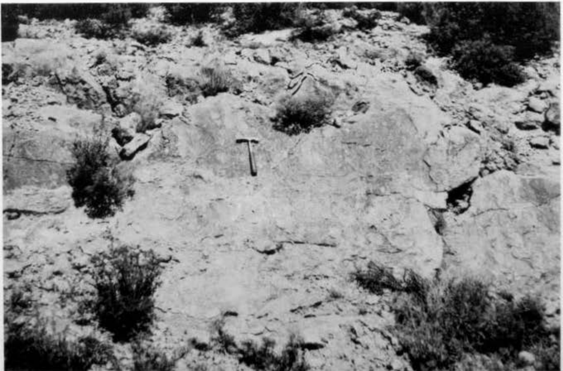
Foto 11: Superficie de Falla.
