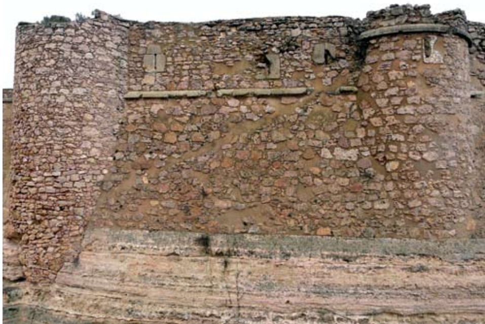
Fig. 16. Lienzo 07 con marca diagonal de la antigua canalización para bajada de aguas.
