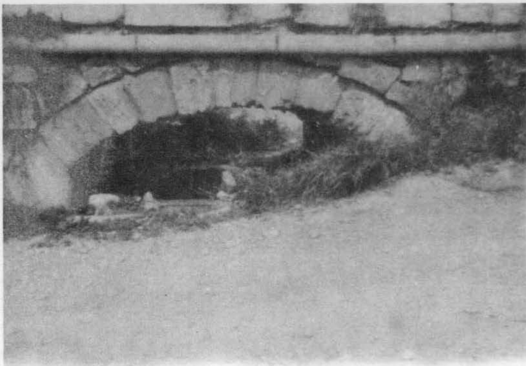
Puente número 3.- Vista del arco aguas abajo antes de ser obstruído por un amontona- miento de basuras y escombros.
