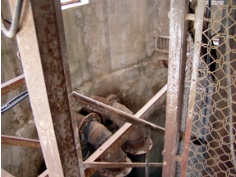
Imagen 26. Tuberías de salida Deposito Elevado (2007). Fotografía Antonio Caulín.
