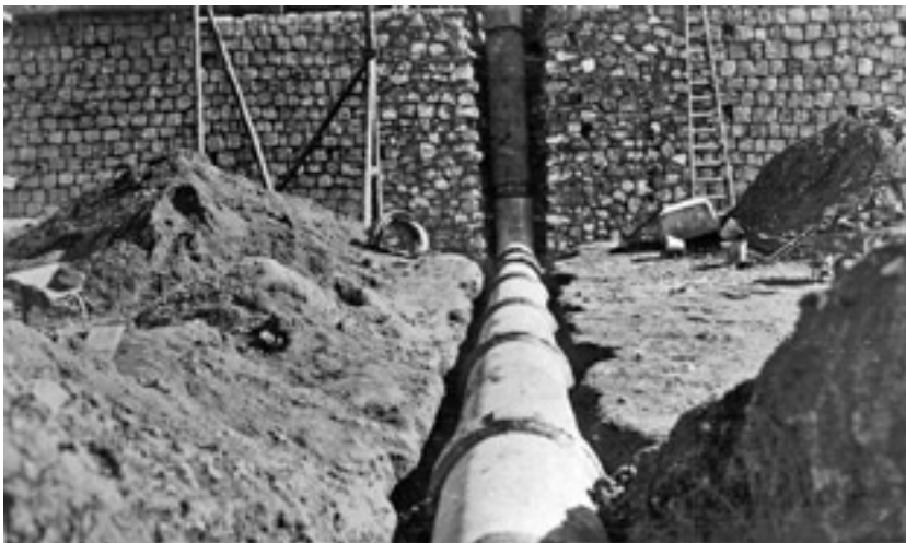
Imagen 9 Tubería hasta el depósito de almacenaje. AMAB, fotografía s/núm.
