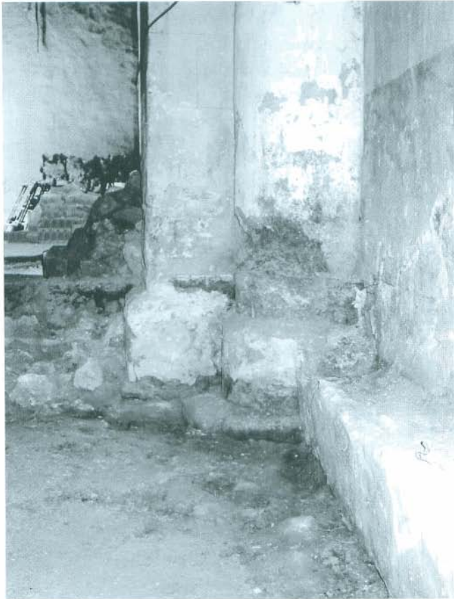
Fot. 26. Ermita. A la izquierda el corte del relleno efectuado en el paso de la nave al presbiterio.
