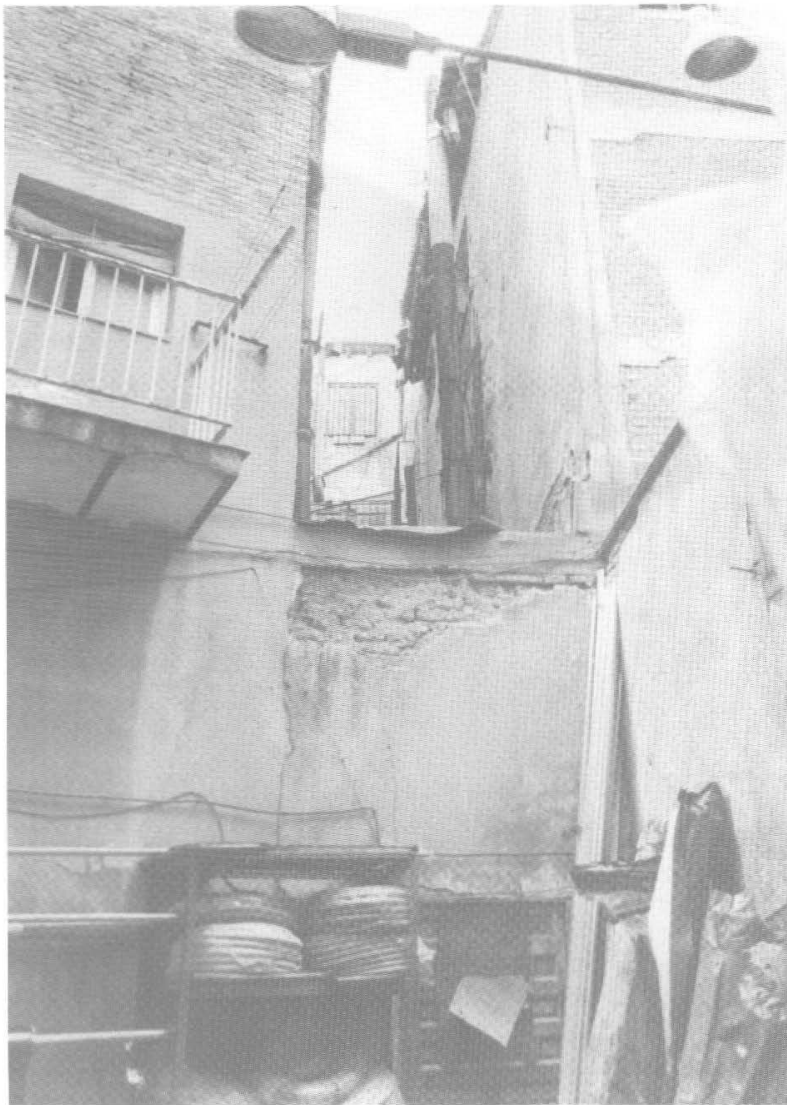
Callejuela de los Urbinas. Estado actual del tramo perpendicular a la calle Mayor visto desde el interior del edificio de la Telefónica.
