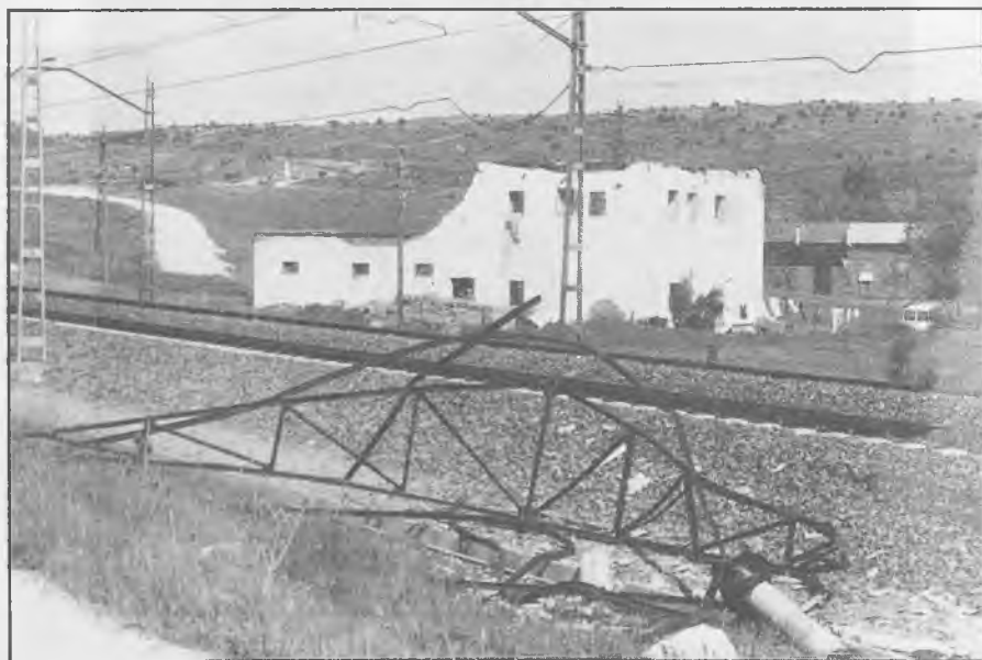
Estado en que quedó la vivienda de Tomás Martínez Hervás
