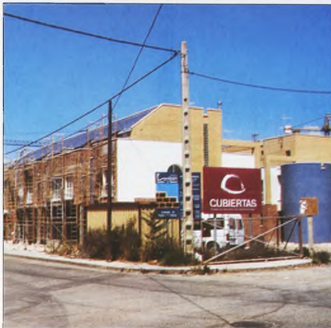
Estas son parte de las 111 viviendas que se construyen para ellos en Pío XII.
