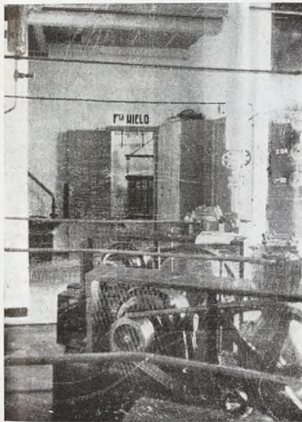
Las frigorías necesarias para el normal funcionamiento de las siete cámaras y la fábrica de hielo están producidas por un grupo de tres compresores. Este es uno de ellos.
