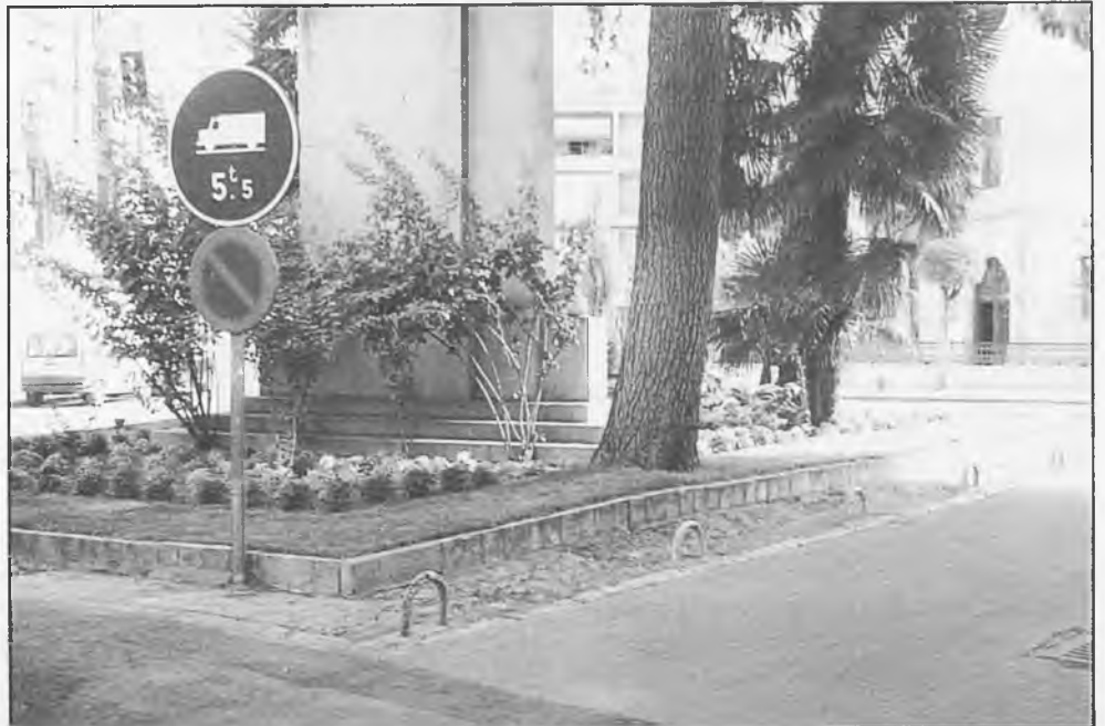
Se colocaron unos pivotes metálicos, para evitar que los coches aparcasen en la acera de la Cruz de los Caídos, pero aún no se ha reparado, mostrando este lamentable aspecto en la actualidad.
