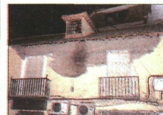
Fachada afectada por el derrumbe.
