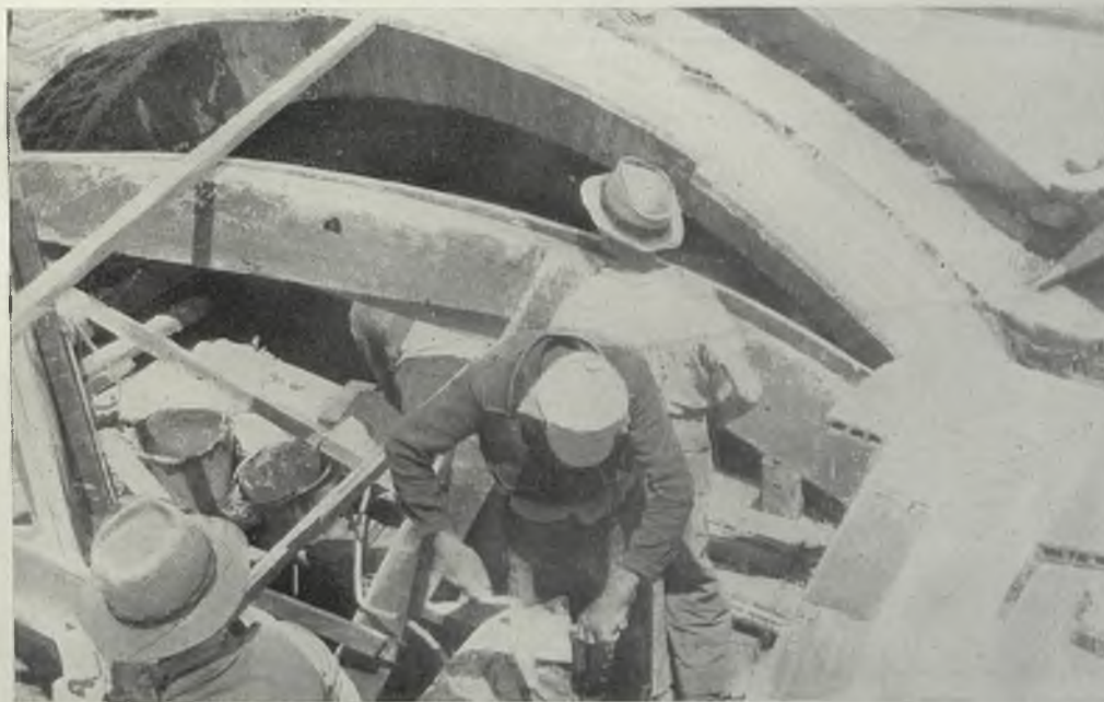
SUCRE.—Otro aspecto de la construcción de las bóvedas del Templo de la Recoleta.
