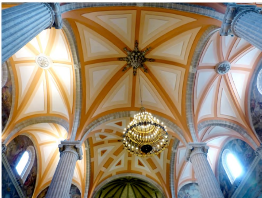
Foto 1.- Catedral de Albacete. Las seis bóvedas que se construyeron en 1698-1699. Fot. J. S. Ferrer.
