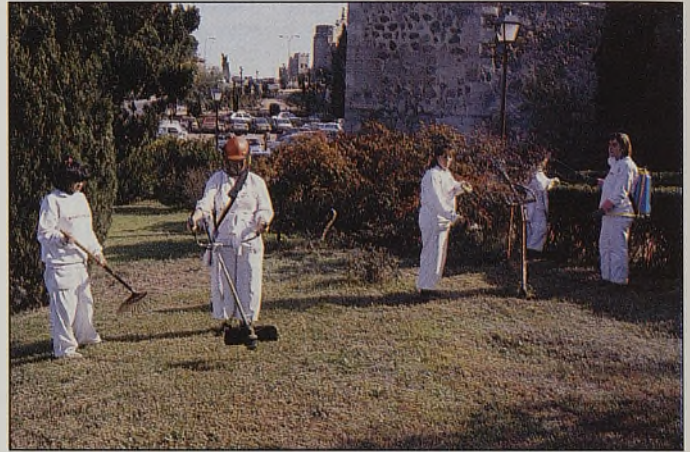
Los alumnos de la Escuela Adarves recuperaron los jardines de las puertas de Bisagra y Alfonso VI, a la vez que trabajaron durante todo el año en la rehabilitación de las murallas.
