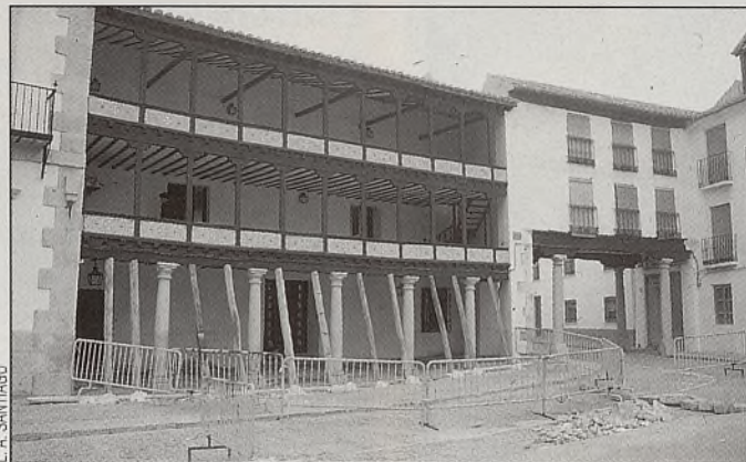
Una avería en la acometida de aguas provocó serios desperfectos en la Plaza Mayor de Tembleque.
