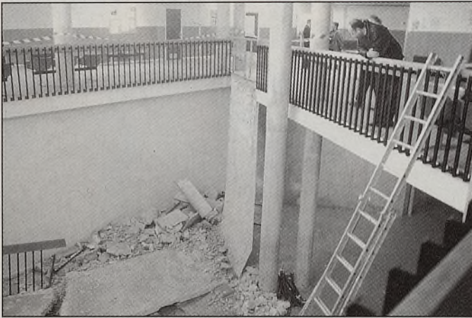
Febrero acabó con un buen susto en el Centro de Enseñanzas Integradas, al derrumbarse la escalera de hormigón del pabellón uno. Por suerte el desplome no se produjo a una hora punta y tan sólo resultaron heridos de carácter leve cuatro alumnos.
