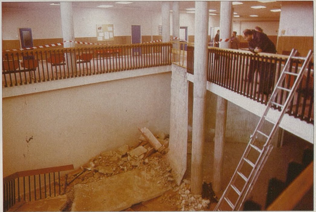
A finales del mes de febrero se derrumbaba la escalera en el Centro de Enseñanzas integradas.
