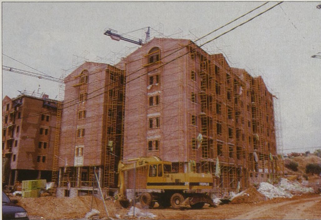
Algunas viviendas están paralizadas por falta de compradores.
