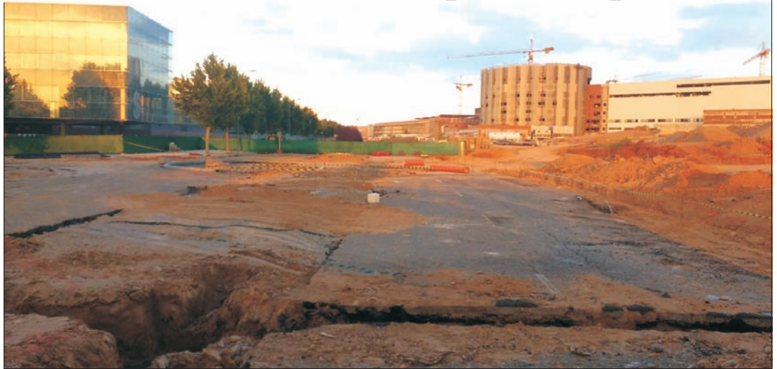
Rotonda que se está construyendo en la calle Guadiana, junto al nuevo hospital.
