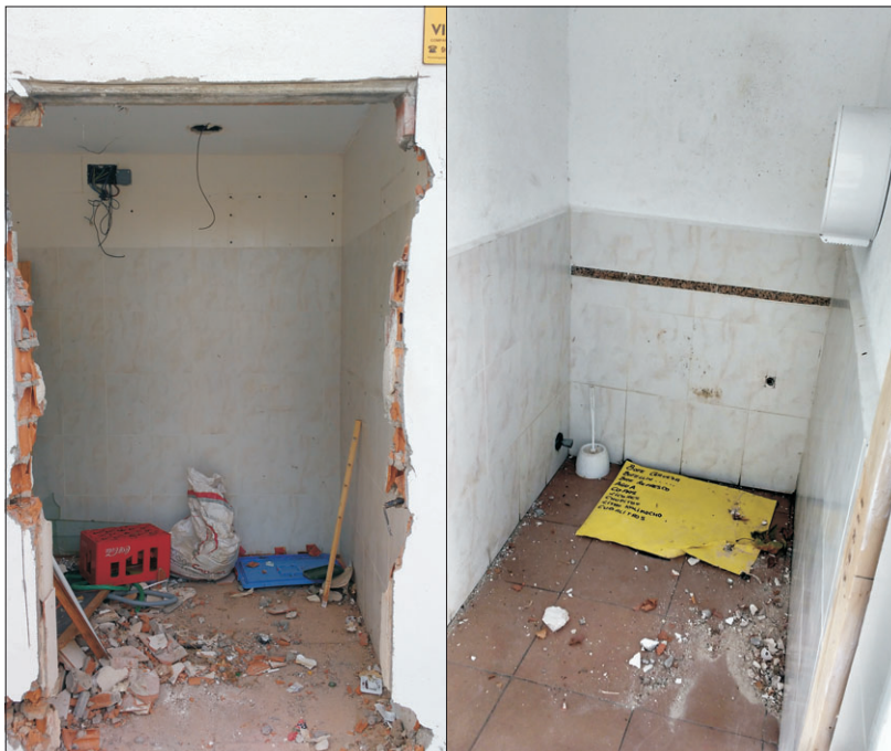
Estado en que se encuentran almacén y servicios.
