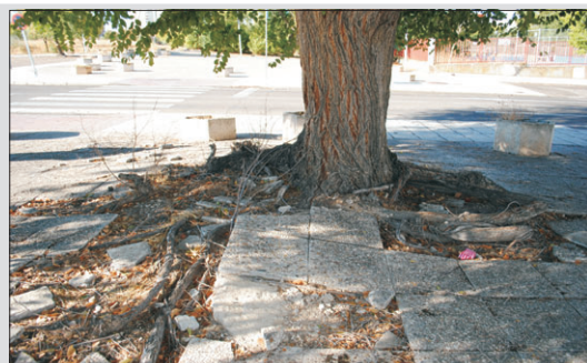
Las raíces están destrozando el acerado sin que se ponga remedio.
