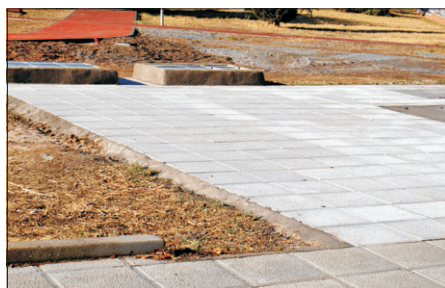
¿Por qué no se ha seguido rematando con bordillo el solado de esta meseta?
