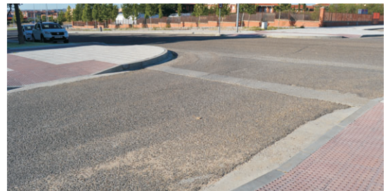
Más de tres años, solicitado en diversas ocasiones, y sin pintar el paso de peatones.
