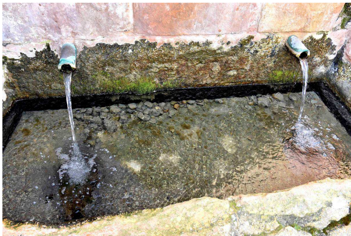
Aspecto de los caños
