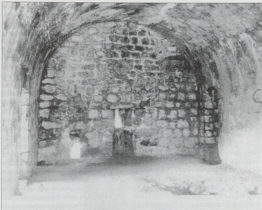
Vista del paramento norte de la sala alta del Molino del Cubo
