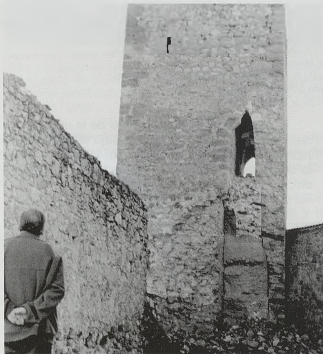
Fotos previas al Proyecto de Restauración de las torres de la muralla de Cifuentes junto a la Puerta Salinera redactado en el año 1972 (no realizado). Esta fotografía pone de manifiesto el estado de la muralla y su proceso de construcción cuando se decide reparar la vieja cerca de tierra, así como el adarve o paso de ronda y su correspondiente pretil. Archivo General de Administración. Sección Cultural, (3) 005.003,51/11303
