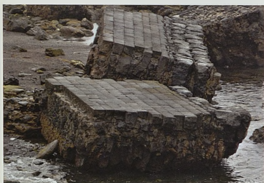
Figura 6. Restos de Santa Catarina das Mós: a: grandes bloques de sus frentes volcados en la playa tras la desaparición por efectos de las olas del terreno sobre el que se asentaban; b. zanja de cimentación del frente de tierra visible por esta erosión
