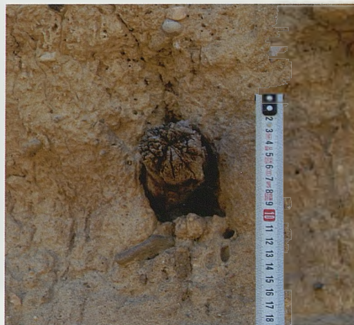
Figura 11. Detalle de uno de los mechinales en la tapia de la Cartuja donde todavía se conserva la aguja con la que se construyó, al haber quedado embebida en la masa de relleno, reflejo de la voluntad de no querer reutilizarlas (M. A. Martín, 2015)
