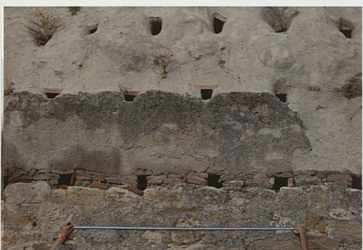
Figura 9. Detalle de uno de los cajones inferiores en el que se puede ver claramente la disposición de los mechinales dentro del cajón, así como una junta constructiva en el mechinal de la izquierda. La colocación de los mechinales dentro del cajón marca la dirección de ejecución del tapial, en este caso hacia la izquierda. (E. Herrero, 2015)
