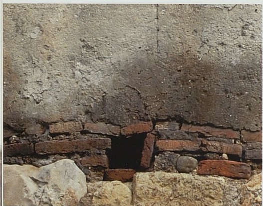
Figura 13. Detalle de un mechinal con disposición lateral dentro del cajón. El ladrillo-dintel, que en este caso está roto, se encuentra desplazado hacia la izquierda, apoyándose en un ladrillo a tizón. En la imagen también se puede ver la junta constructiva entre cajones que se conserva en el revestimiento (E. Herrero, 2015)
