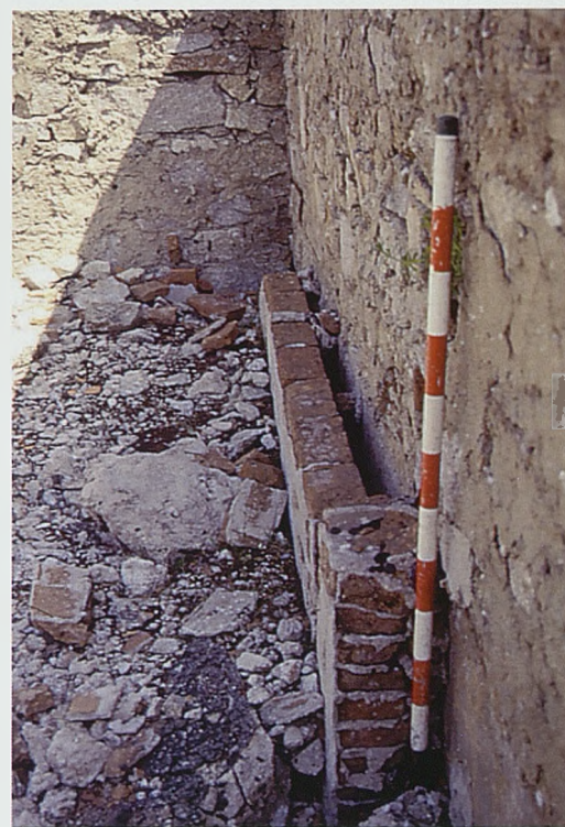
Figura 18. Fotografía de finales de la década de 1990 en la que se aprecia el doble tabique que presenta el muro exterior, con función de aislante térmico y anti humedad
