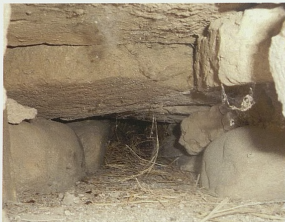
Figura 20. Interior de mechina para agujas apoyadas sobre el muro de mampostería, construido por dos paredes de canto rodado y cobija de ladrillo. Mechinal del nivel inferior conformado sobre la fábrica de mampostería (E. Herrero, 2013)
