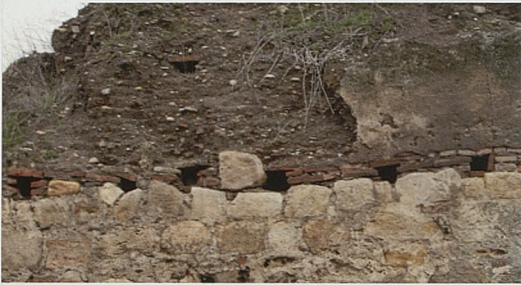
Figura 17. Observando este encintado, se comprueba que no está ejecutado de forma unitaria y continua a todo lo largo del lienzo, sino que se va ejecutando por trozos correlativamente con cada cajón (E. Herrero, 2010)
