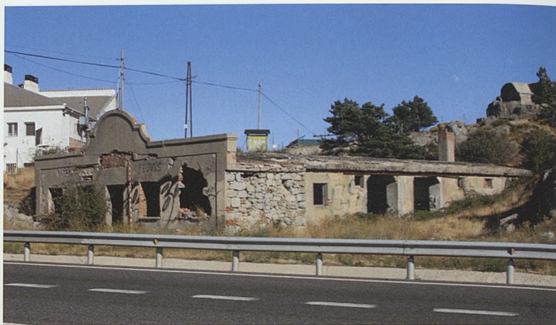
Figura 10. Fotografía de 2015 en la que se aprecia la fachada monumental, la diferente construcción de la nave central y de las alas y la desaparición de las puertas metálicas
