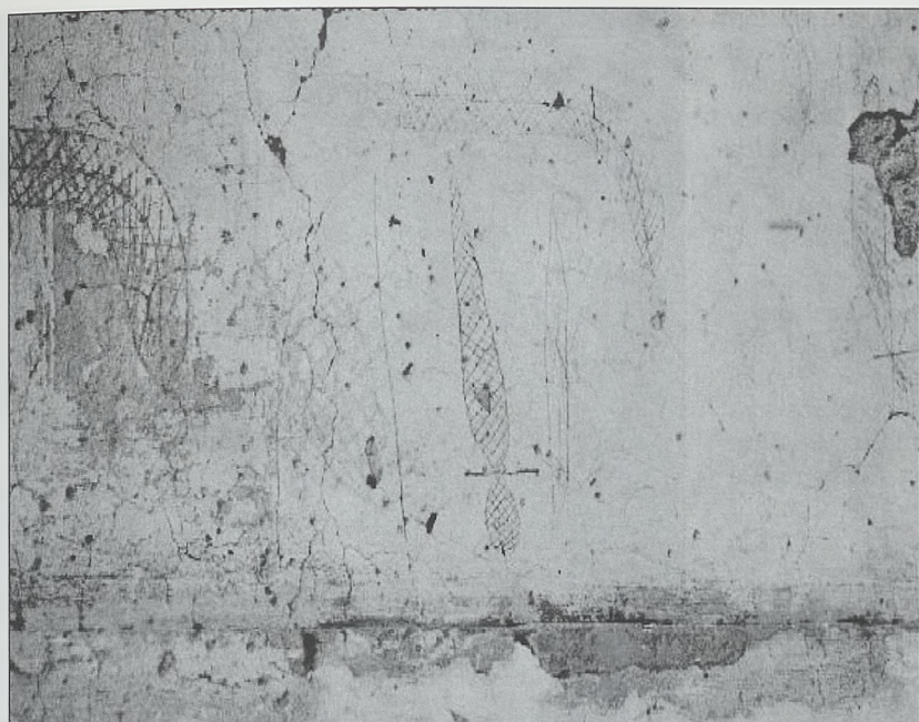
Fig. 16. Grafitos en el muro sur de la Almenara
