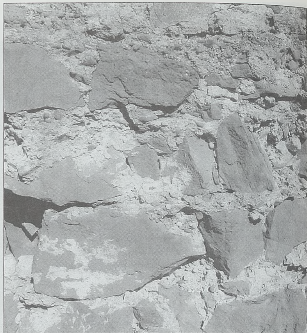
Obra general del interior de los muros del castillo: mampuestos ligados con argamasa (cal, cantos rodados y esquirlas de la mtalla de los mampuestos)
