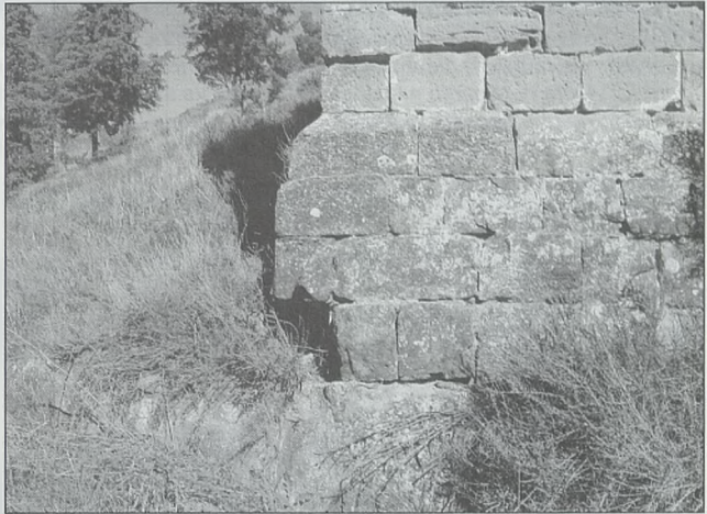
Cimentación de sillares sobre base de roca natural de la línea interior (superior) de muralla. Esquina sudoeste
