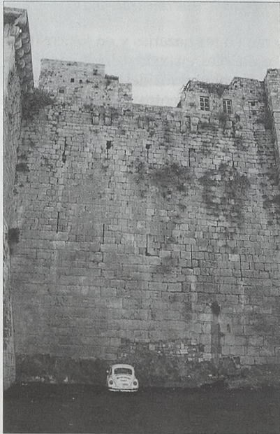
Cortina del recinto externo, junto a la puerta, las saeteras inferiores indican la situación de la rampa de acceso.
