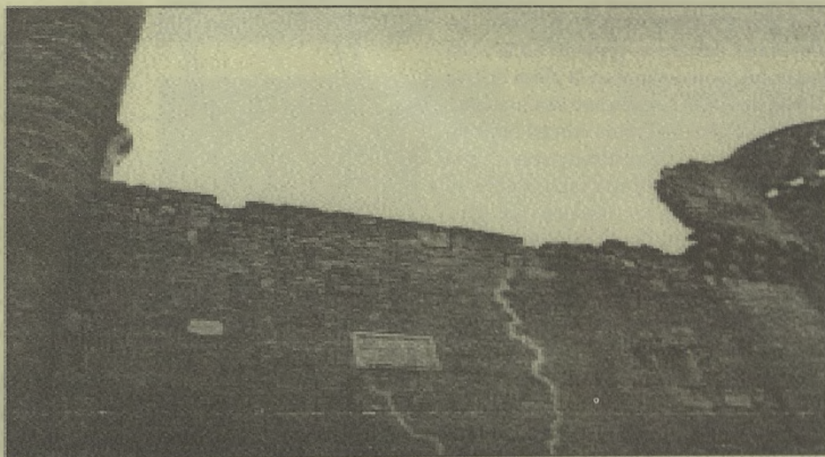
Muralla superior del castillo de Villafuente en la que puede verse una grieta.
