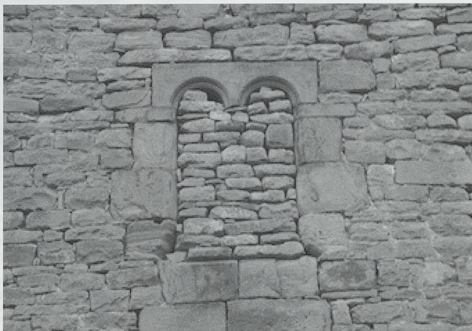
Fig. 11. Palacio de Equisoain: ventana de la planta noble (sala occidental) antes de la rehabilitación
