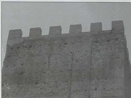
Fig. 30. Torre de Chera. Vista del lado norte. A ambos lados de la zona alta aparecen sendas hileras de maderos incrustados que son los restos de los suelos de las buhardas de ángulo
