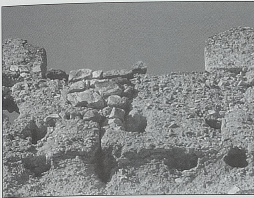
Fig. 15. Castillo de La Pileta de Cortes de Pallas. Detalle de los indicios de la buharda o cadalso de la figura anterior: los mechinales de las tres vigas y el vano de acceso tapiado
