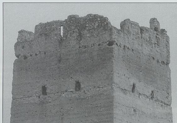
Fig. 4. Torre de Mussa (Benifaíó). Vista del ángulo suroeste. En los ángulos de la zona subyacente al parapeto superior se muestran los mechinales de las vigas de las buhardas o cadalsos: obsérvese la viga de ángulo y las puertas de acceso a los dispositivos
