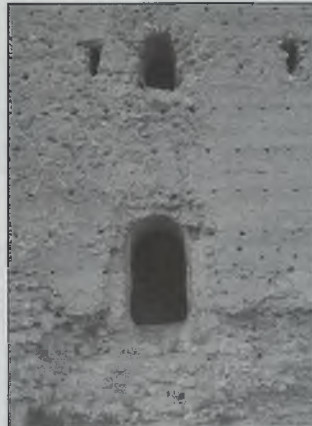
Fig. 22. Torre de Montroy. Vista parcial del lado sur. Abajo aparece una puerta, ligeramente elevada, en cuya vertical se ubica un vano superior más pequeño, flanqueado por saeteras, en el cual se situaba un dispositivo lígneo para protección del acceso
