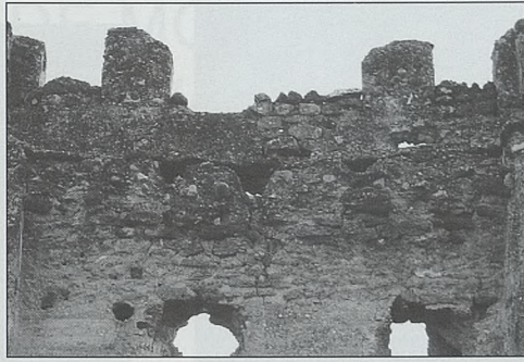
Fig. 16. Castillo de La Pileta de Cortes de Pallas. Vista interior de la torre mostrando en su zona central los indicios de la buharda o cadalso, con los tres mechinales para las vigas (situados bajo la gruesa capa de argamasa del suelo del adarve) y la puerta tapiada con mampostería
