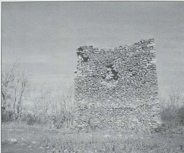
Vista general del El Cubo y el efecto en su estructura del fuego artillero
