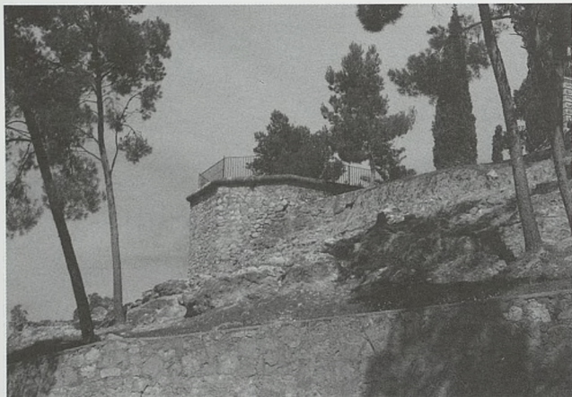
Batería Oeste. La planta superior ha desaparecido totalmente
