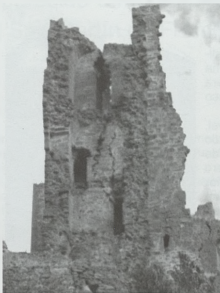
Fig. 9 Vista del paredón norte desde el exterior, al borde del desplome (Autor)
