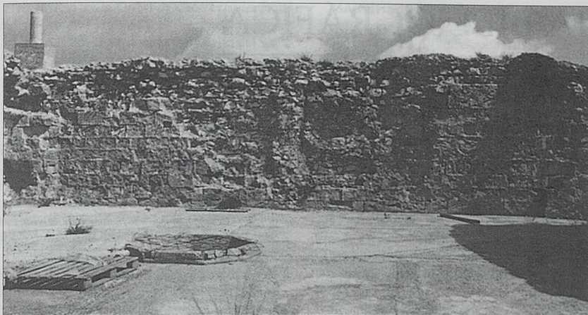
Fig. 9. Primera planta de la torre del homenaje donde puede verse la terminación superior del paramento.
