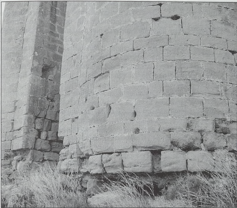
Pésimo estado de conservación de la base de la torre I, en voladizo, al igual que otras numerosas partes de la fortaleza
