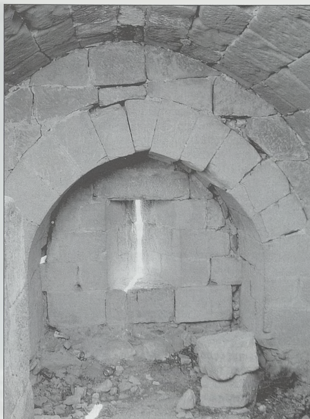
Cámara de tiro de la planta 1 de la Torre del Homenaje que batiría la sección este de la fortaleza. Obsérvese su enorme similitud con las cámaras de tiro construidas en Tierra Santa en plena Edad Media
