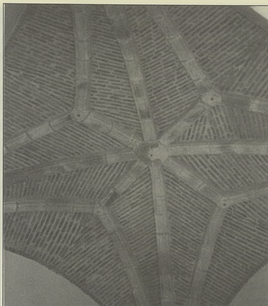
Imagen final de la bóveda de la capilla cercana al cuarto de Garcilaso
