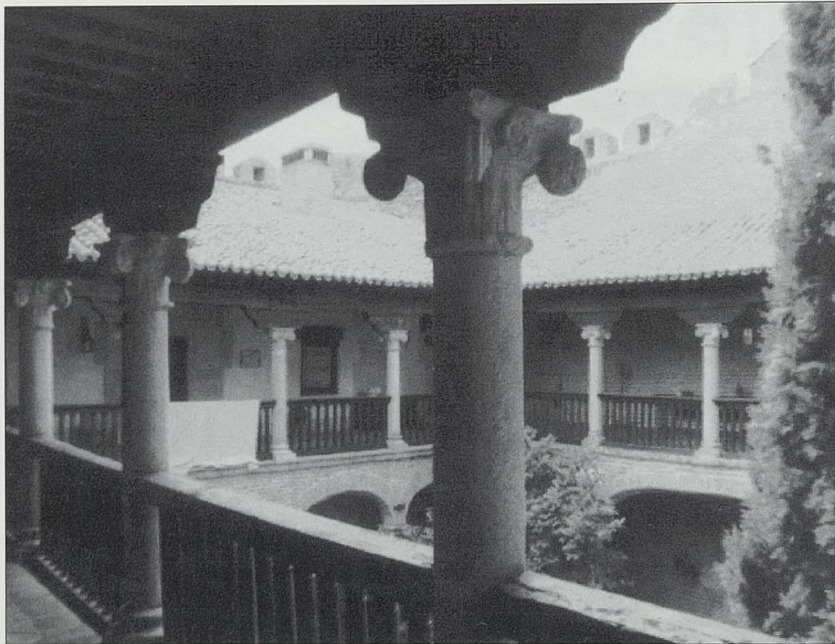
Estado del patio del castillo de Batres después de su restauración.
