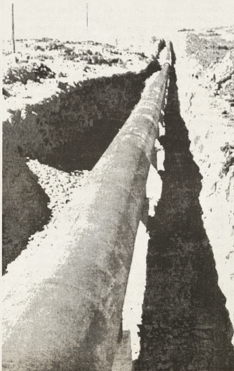
Tubería forzada del abastecimiento de agua. 1950.
