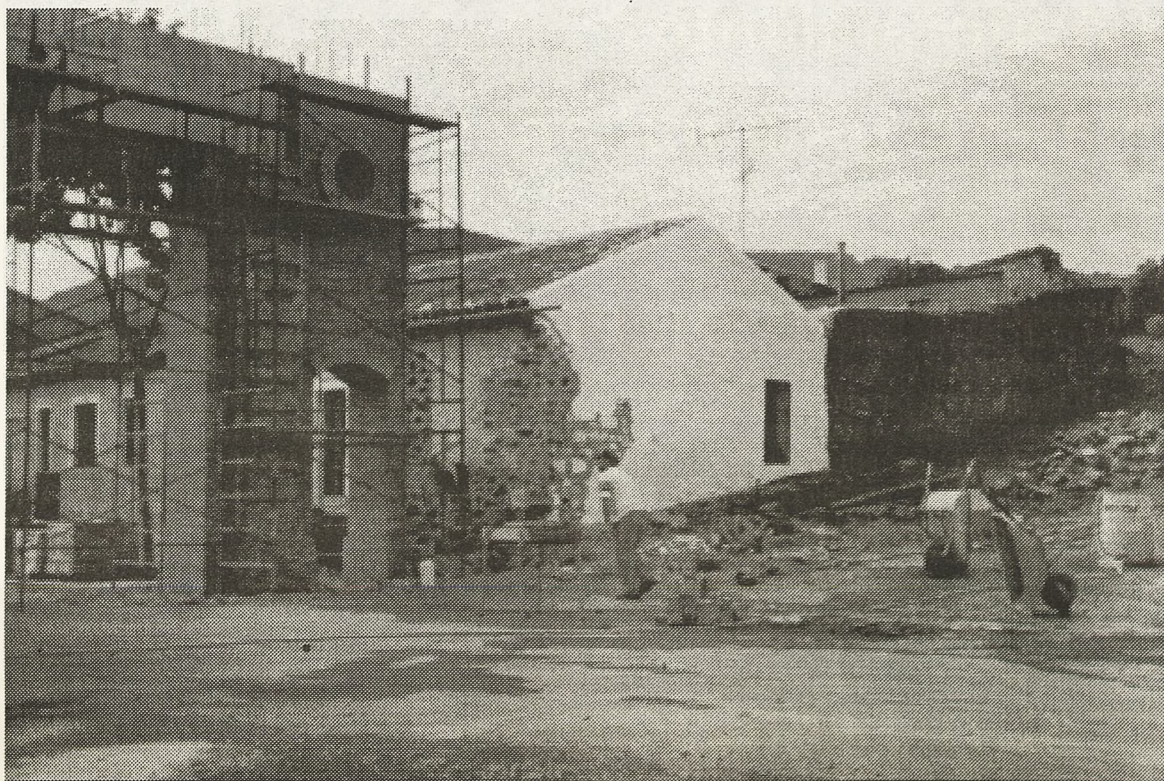
Reconstrucción de la puerta de Almadén en el recinto amurallado de Almadenejos
