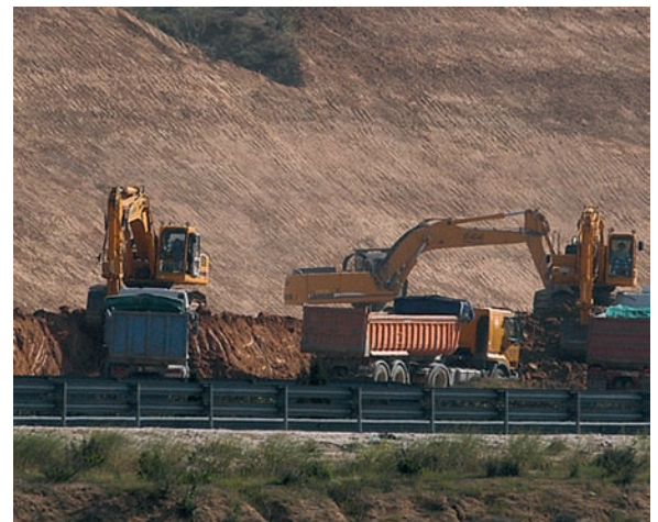
El sector se ha visto arrastrado por la construcción.
