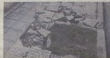
Así se encuentran las aceras.
