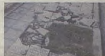
Así se encuentran las aceras.
