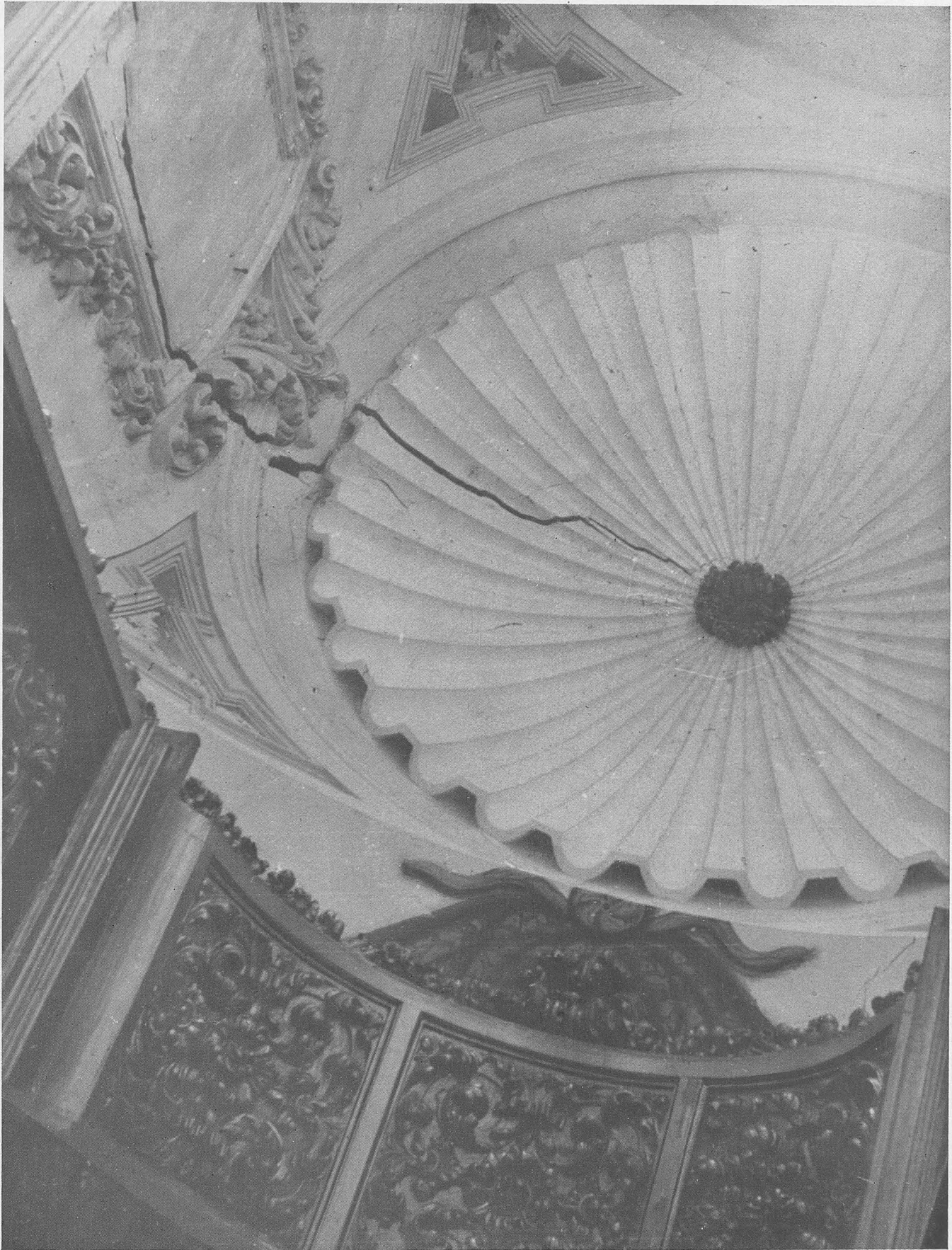
TOLEDO.—Iglesia de San Marcos. Grietas en la cúpula de la capilla lateral derecha.
