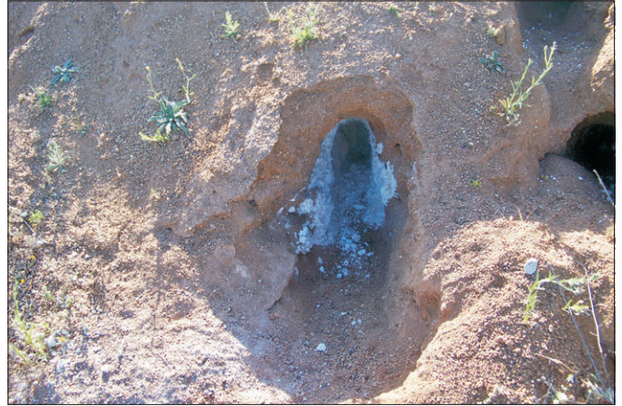
Los conejos al hacer las madrigueras dejan al descubierto los lodos.
