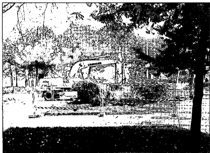
Imagen de una de las obras del Plan E del presente año. / I. BALLESTERO
