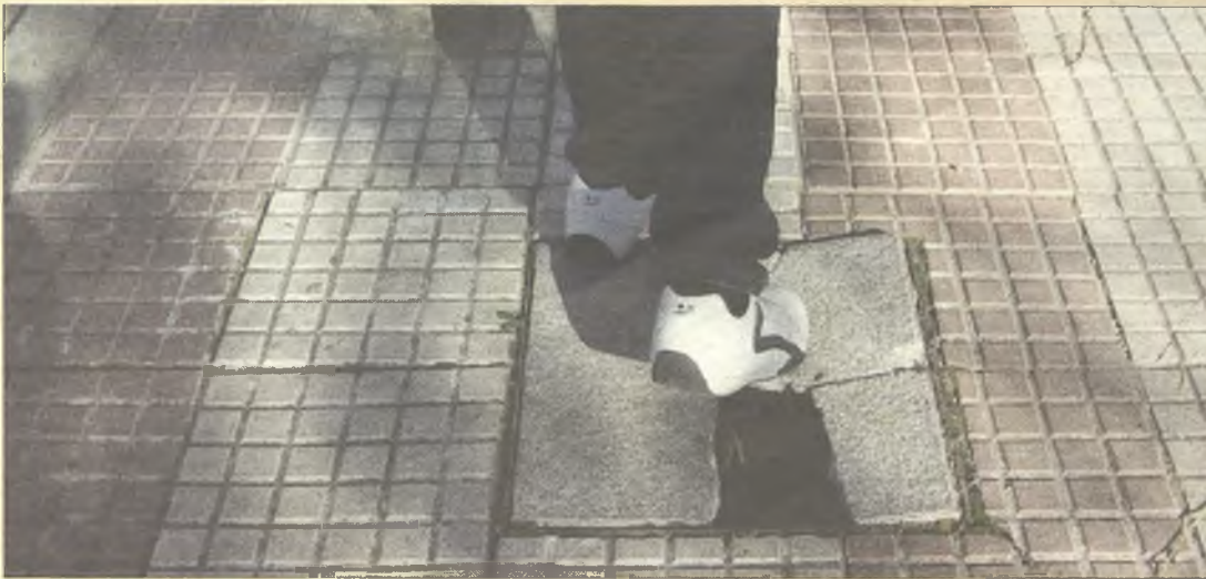
> En la calle Camilo José Cela, de la capital, existe este peligroso agujero en plena acera.
