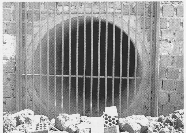
La red de tuberías es insuficiente ante grandes tormentas.
